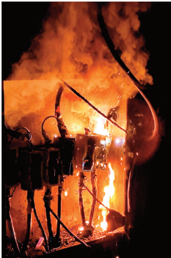
दीनदयाल कालोनी में जला ट्रांसफार्मर
